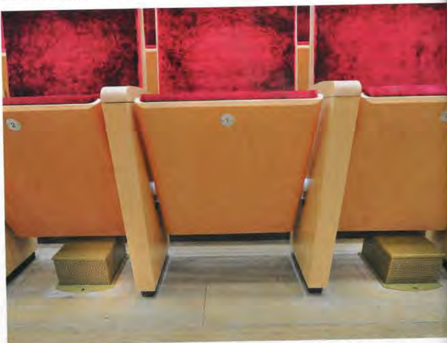
Bouches de soufflage, sous faces pleines, bois revenant sur les tranches des assises
